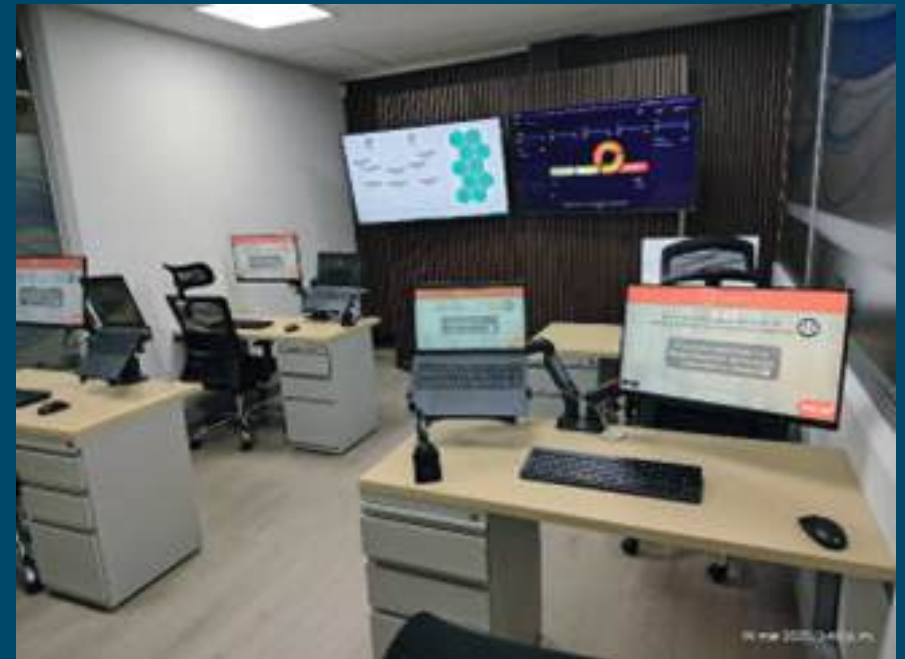
Centro de Monitoreo NSOC de Itelca
